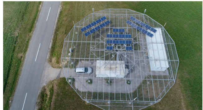
Bild 8: Photovoltaik-Anlage auf der Antennenplattform der ehemaligen Funkanlage am Standort Freistadt
